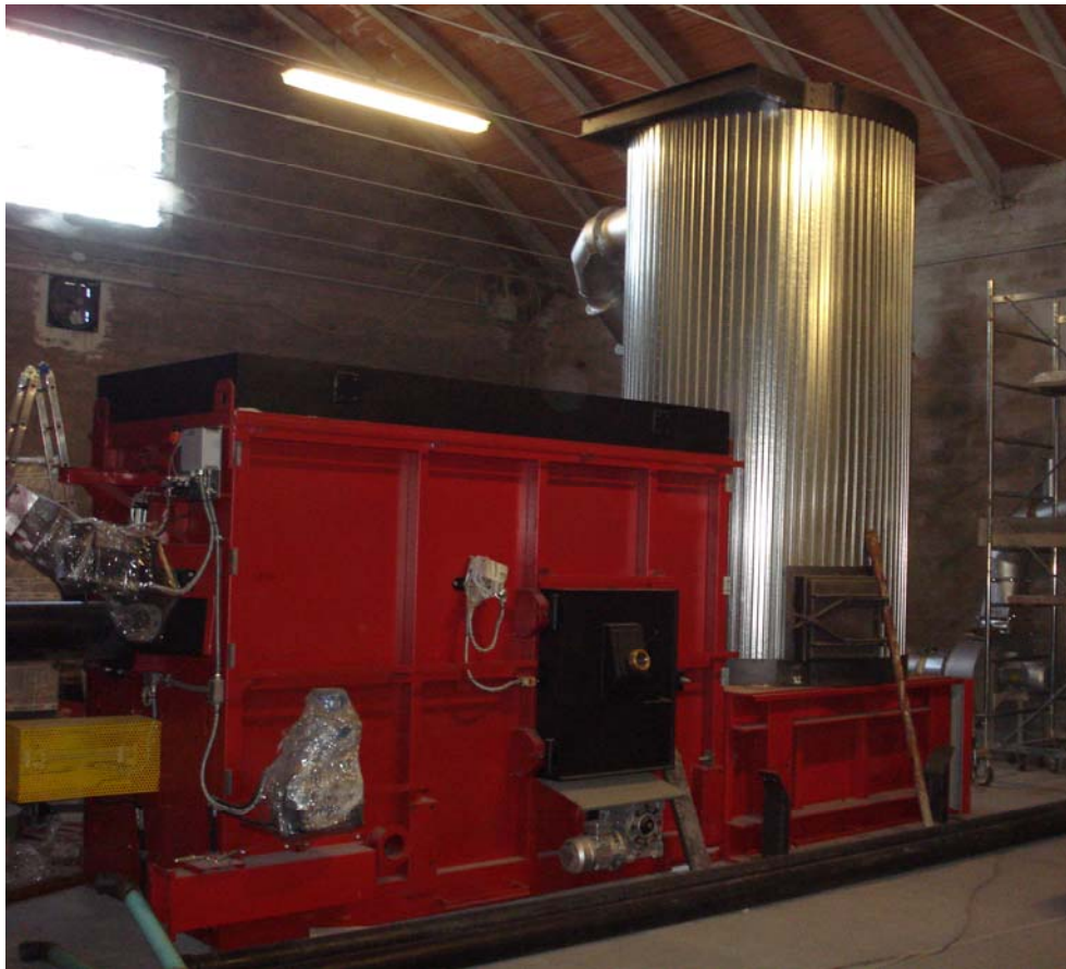
Fig.4: Caldaia a biomasse ad olio diatermico
